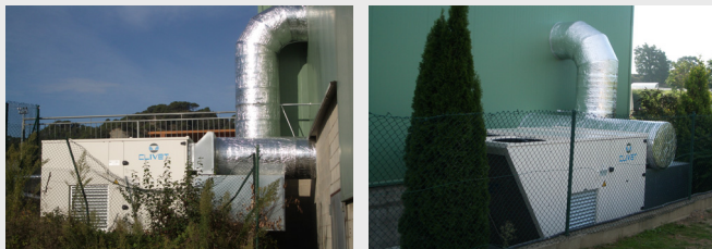
Pabellón Deportivo Municipal – Pompe di calore rooftop geotermica ed aerotermica
